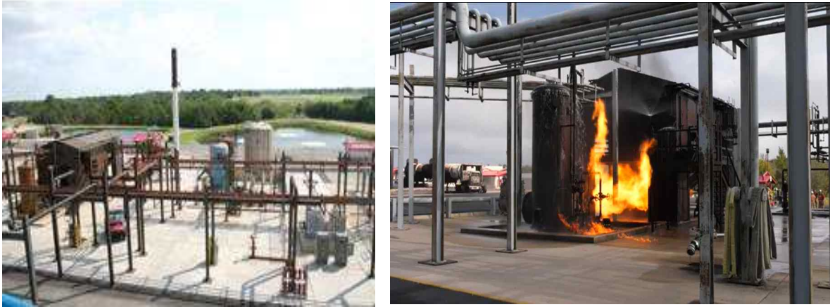
[그림 30] Compressor Station Fires(teex.org)
